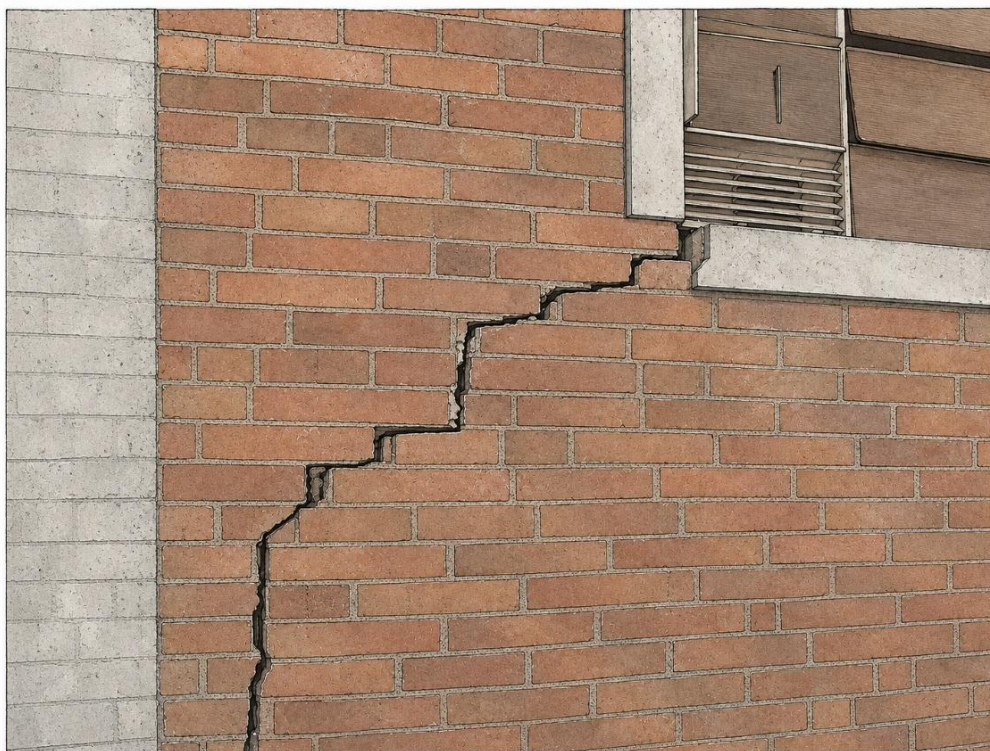
Figura 9 – Rachadura em alvenaria provocada por recalque do solo abaixo da edificação.
